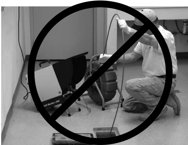
Figure 27 – Mauvaise technique de poussée du câble
